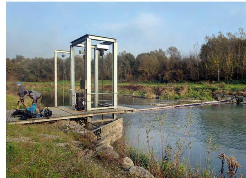
Abb. 3: Fischwehr, Standort Fall (Kraftwerk Ottensheim-Wilhering).
