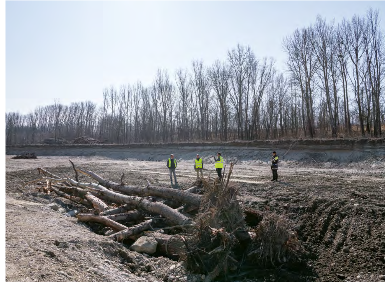
Abb. 2: Renaturierung bei Altenwörth mit Totholzstruktur im Bett des zukünftigen Nebenarms. Baustellenbegehung im März 2021. Von links: Karl Heinz Gruber und Michael Amerer (Geschäftsführer der VERBUND Hydro Power GmbH), Projektleiter Hannes Einfalt (VERBUND Hydro Power GmbH) und Florian Seidl (Projektkommunikation VERBUND AG).
