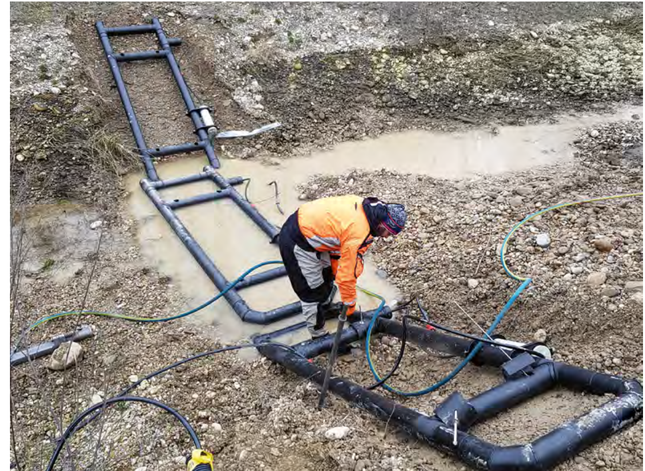
Abb. 7: Montage der PIT-Tag Antennen in der Fischwanderhilfe.
