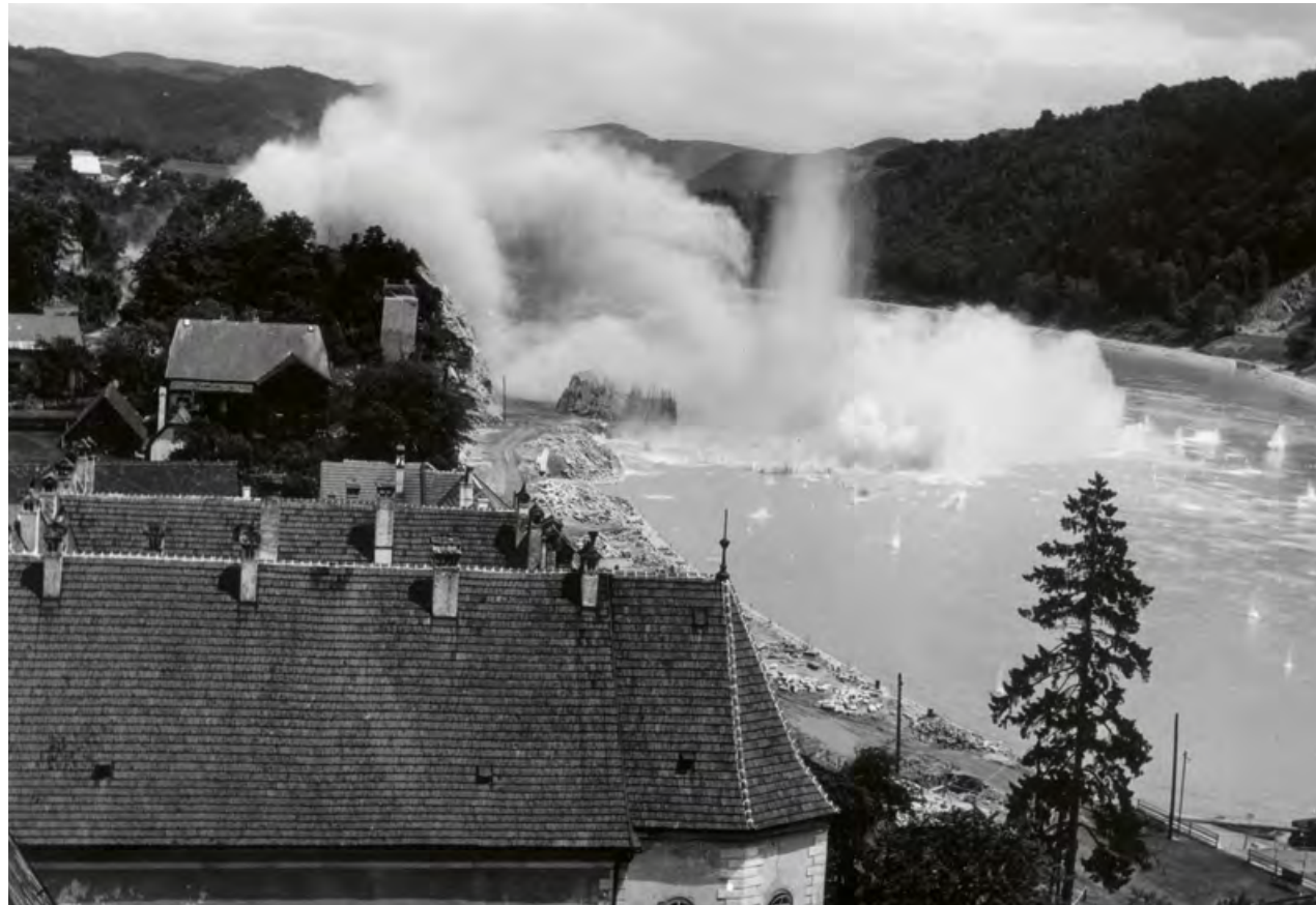
Abb. 8: „Freitag, Punkt 12:30, wurde in Grein an der Donau mit Sprengstoff Geographie gemacht.“ – So formulierte die Arbeiter-Zeitung tags darauf, am 14. Juni 1958, die Sprengung des ehemaligen Schifffahrtshindernisses Schwalleck im Zuge der Kraftwerkerrichtung 1958.
